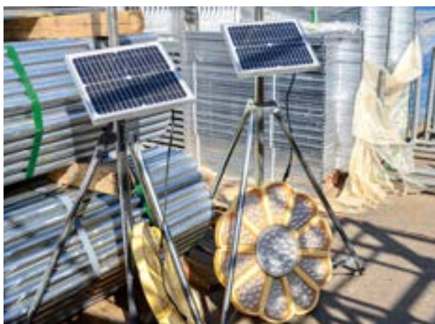
最近のソーラーパネルは高性能です。工事中であることを知らせる標識などに使用します。
